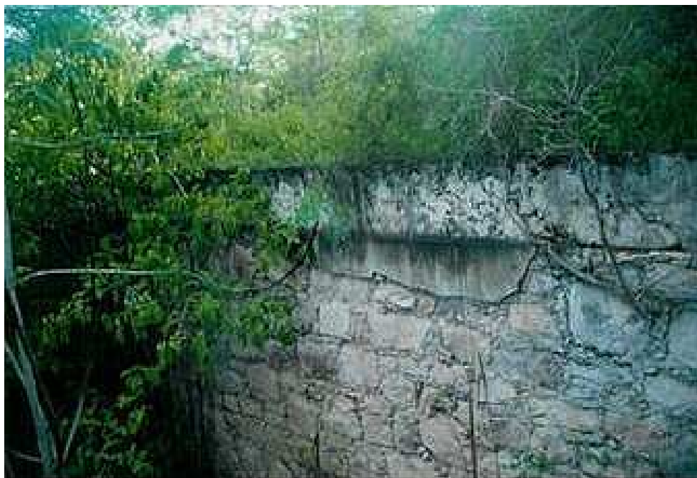
FIGURA 24 - Visão parcial de uma das laterais do antigo tanque. Devido rachadura no piso estão crescendo árvores e arbustos. Foto: Eliane Sampaio.
