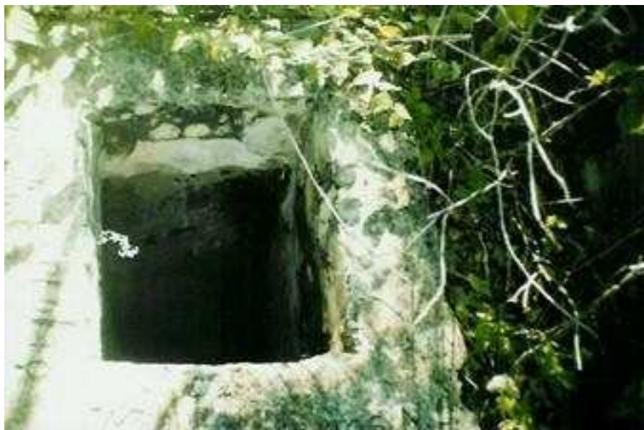
FIGURA 25 - Suspiro para a saída de água em caso de transbordamento. Foto: Eliane Sampaio.
